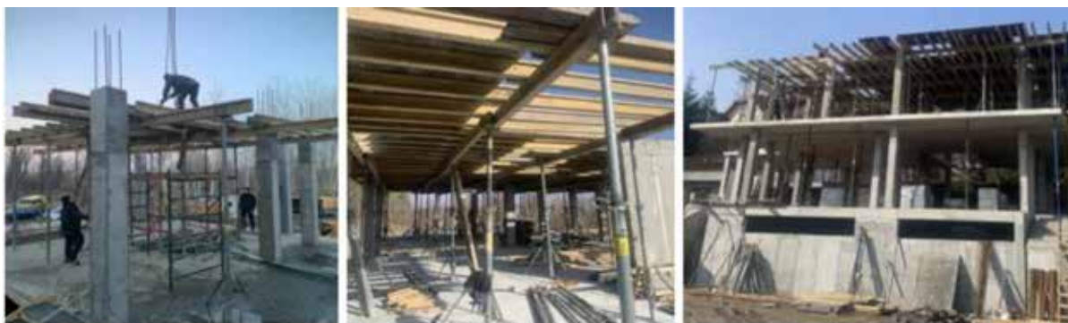
Рис. 3. Проведення попереднього огляду об'єкта з визначенням зон найбільшого зносу та пошкоджень (прогину плит перекриття, балок, ригелів)
